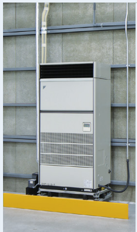
■4階倉庫内空調
