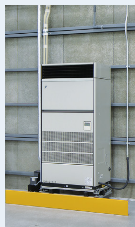
■4階倉庫内空調
