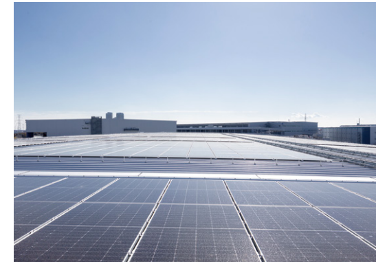
太陽光パネル
