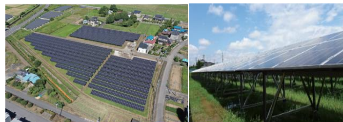
埼玉県加須市 第1号 非FIT太陽光発電設備 発電設備容量1.3MW/2020年10月発電開始
