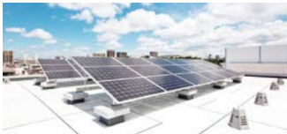
ヒューリック深沢の屋上に設置された太陽光発電パネル
