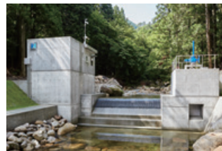
小水力発電(滋賀県高島市)
