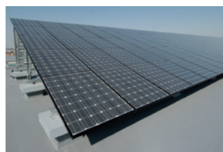
ヒューリックコート雪が谷の太陽光発電設備
