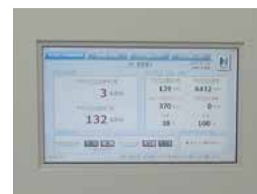
見える化システム(ヒューリック浅草橋ビル)
