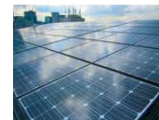
太陽光発電装置(ヒューリック本社ビル)
