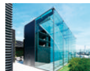
屋上ソーラーチムニー (ヒューリック本社ビル)
