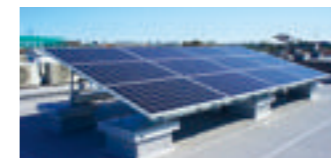
ソナレ石神井の屋上に設置された太陽光発電パネル
