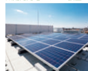
太陽光発電パネル (ホスピタルメント板橋ときわ台)
