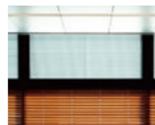
採光ルーバー (ヒューリック本社ビル)
