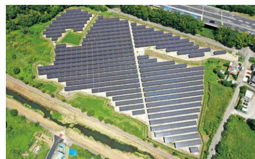
太陽光発電設備 千葉市若葉区
