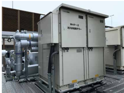
河川水利用ヒートポンプ
