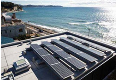
グランダ稲村ヶ崎 鎌倉碧邸の屋上太陽光発電パネル
