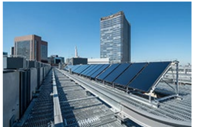
屋上の太陽熱集熱パネル(ヒューリックスクエア東京)
