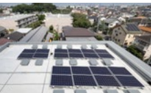
屋上の太陽光発電パネル
