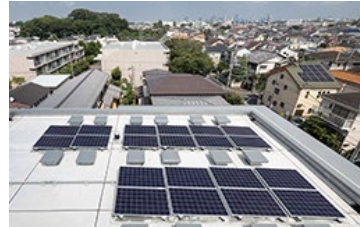
トラストガーデン荻窪の屋上に設置された太陽光発電パネル
