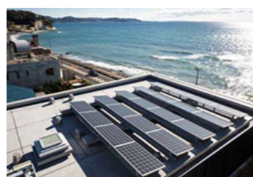
鎌倉碧邸の屋上太陽光発電パネル
