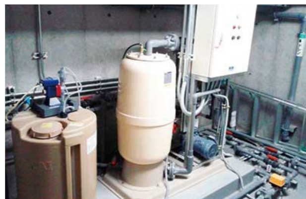
ヒューリック世田谷 雨水再利用装置
