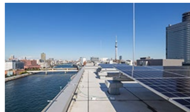
ヒューリック両国リバーセンターの屋上に設置された太陽光発電パネル
