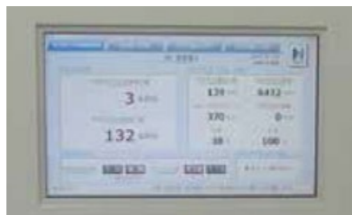
見える化システム(ヒューリック浅草橋ビル)
