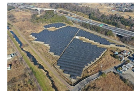
太陽光発電設備（千葉県）
