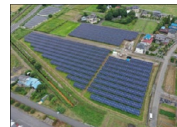
非FITの太陽光発電設備（埼玉県）
