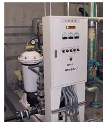
雨水ろ過装置
