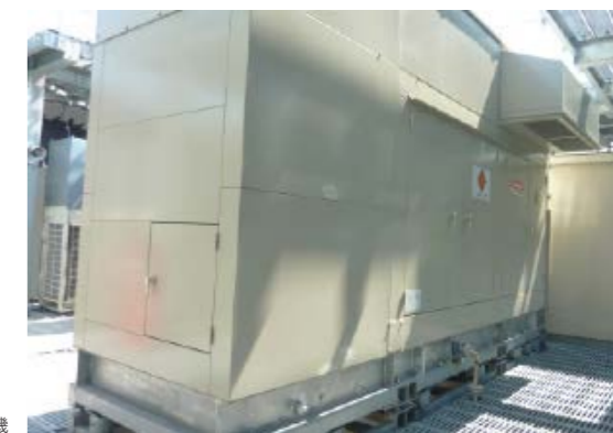
非常用発電機
