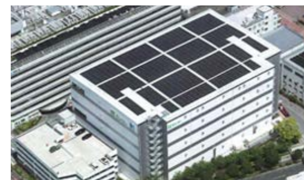
ヒューリックロジスティクス葛西（発電設備容量0.6MW）
