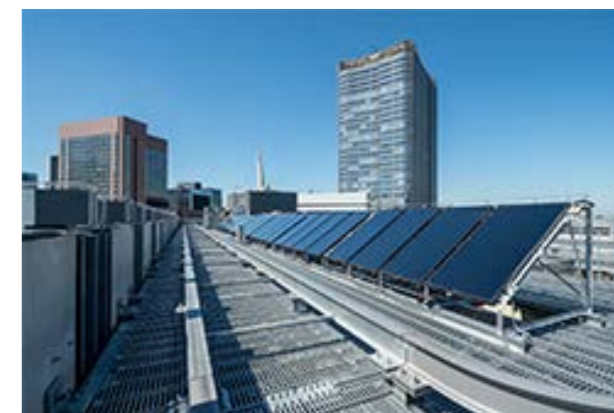
屋上の太陽熱集熱パネル（ヒューリックスクエア東京）
