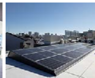
屋上太陽光発電パネル (ソナーレ目黒不動前)
