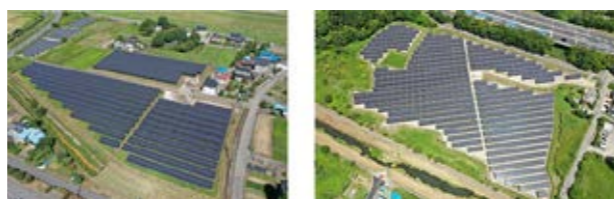
非FIT太陽光発電設備
