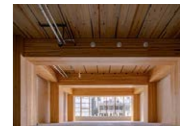
日本初の耐火木造12階建て商業施設 内観（銀座）
