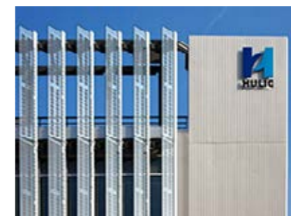
建材一体型の太陽光発電パネル（ヒューリック荻窪ビル）
