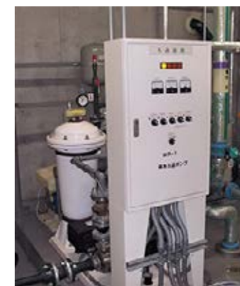
雨水ろ過装置
