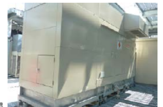
非常用発電機
