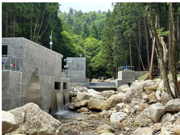
滋賀県鴨川小水力発電所の取水口
