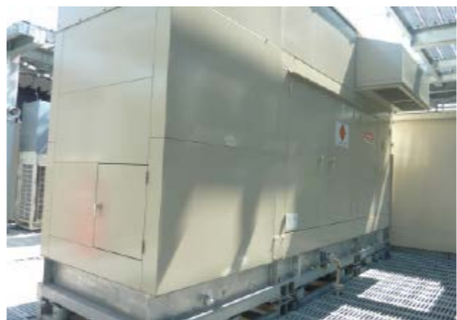
非常用発電機
