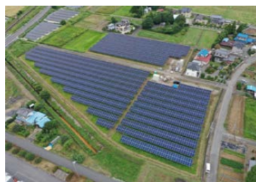
非FITの太陽光発電設備（埼玉県）
